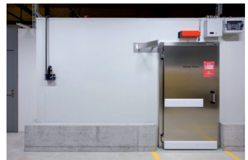
Auffangbehälter für Kühl- und Tiefkühlräume.
